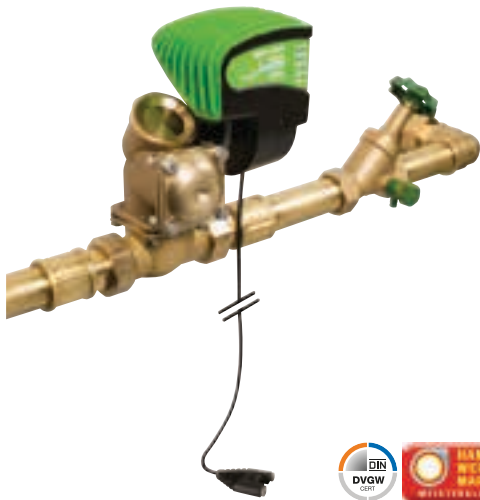
Einbausituation Sicherheitseinrichtung GENO-STOP®
